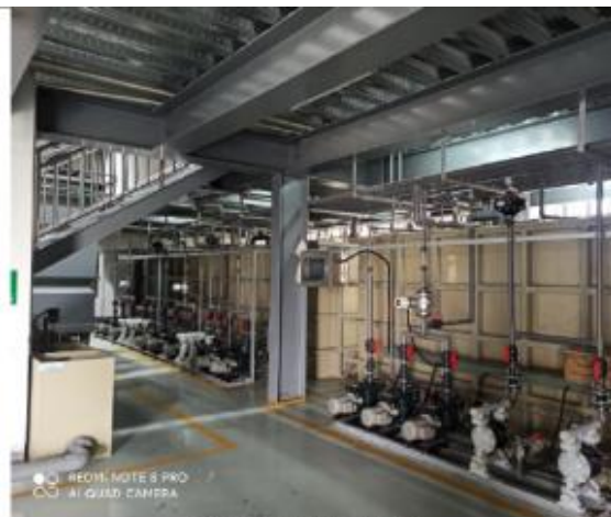
综合废水处理装置
