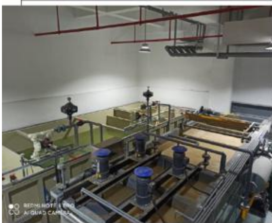
综合废水处理装置
